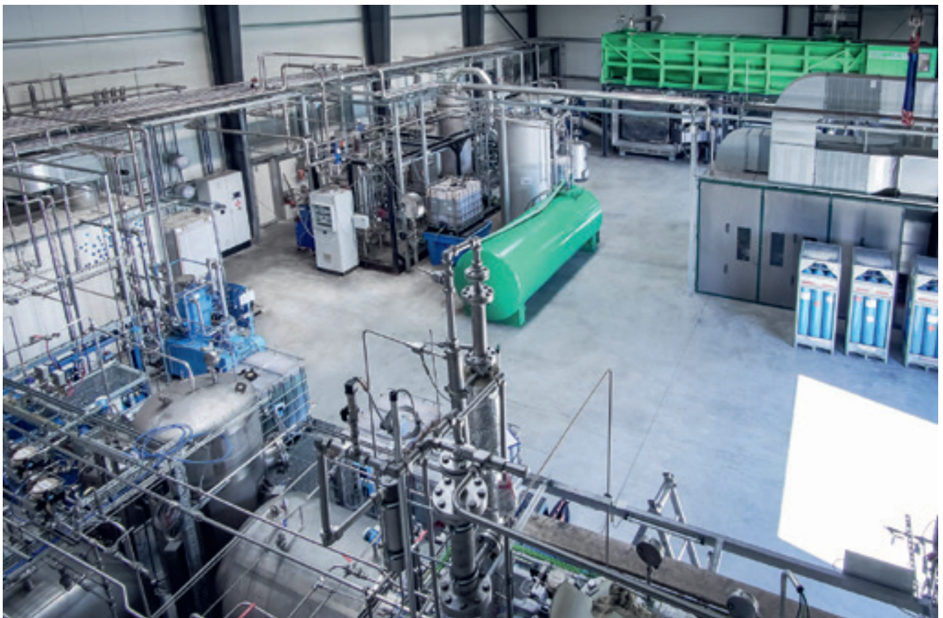
Blick in die TCR®-Technikumshalle für das TO-SYN-FUEL-Projekt im Markt Hohenburg, Landkreis Amberg-Weizbach: Gesamtanlage mit TCR®-Einheit, Gasstrecke, Wasserstoffabtrennung und Hydriereinheit. Quelle: Fraunhofer UMSICHT
